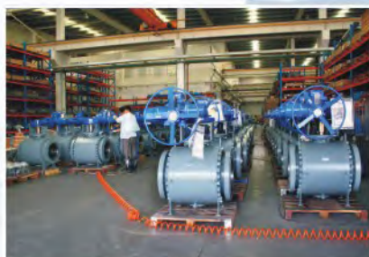
电动管线球阀正在调试中
