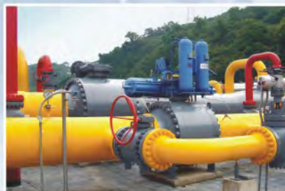
管线球阀使用在天然气管线
